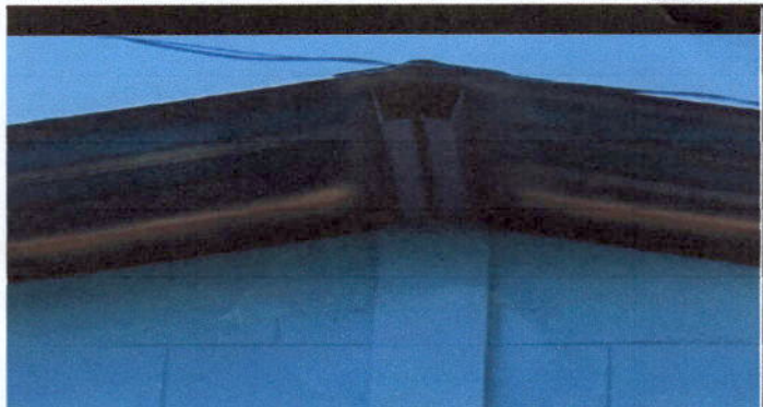
Foto 2: Sustitución de capote, para lámina troquelada aluzinc calibre 26 en módulo de aulas
